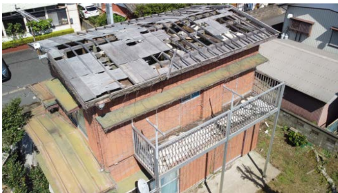
▲屋根材が全て剥離し近隣に部材が飛散している空き家
