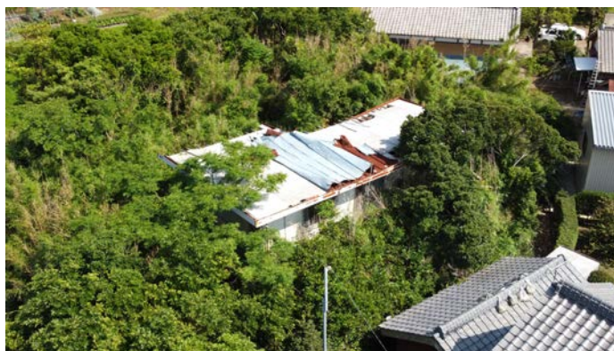
▲屋根材が剥離し立木等が繁茂している空き家
