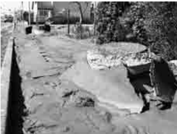
▲隆起したマンホール(新開町)
