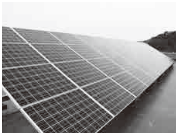
▲校舎屋上に設置されている太陽光発電パネル (小見川西小学校)
