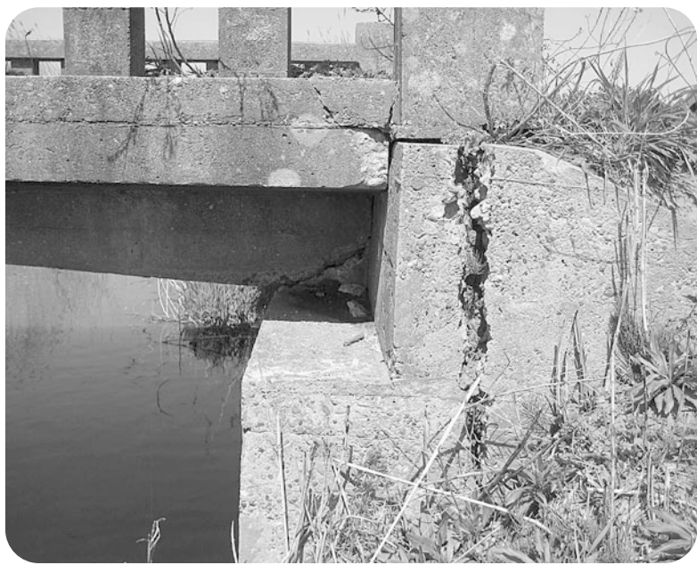
東日本大震災で亀裂が入った市道II-32号線迎田橋(小見川・山田)
