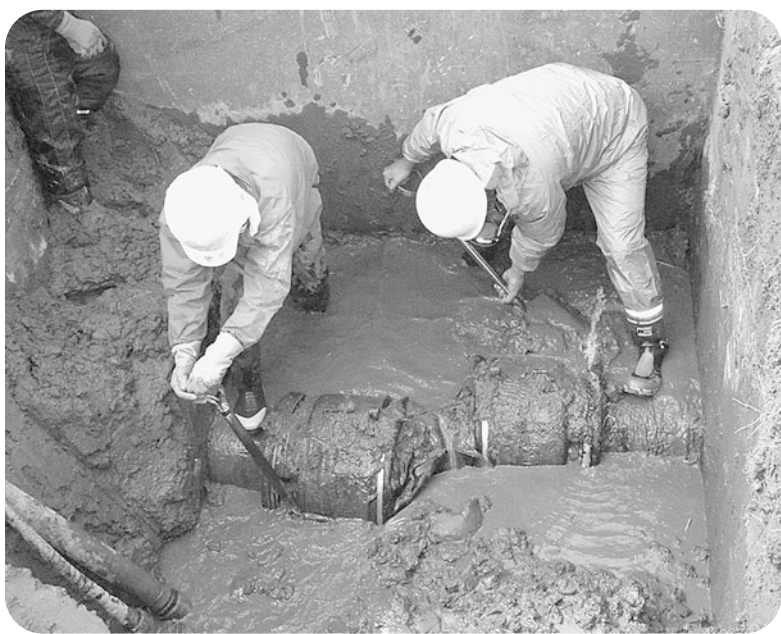
漏水工場の現場(佐原：玉造地先)
