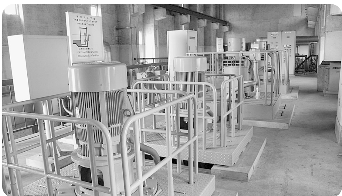
佐原浄化センターの合流汚水ポンプ
