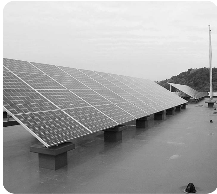
小見川西小学校に設置している太陽光パネル
