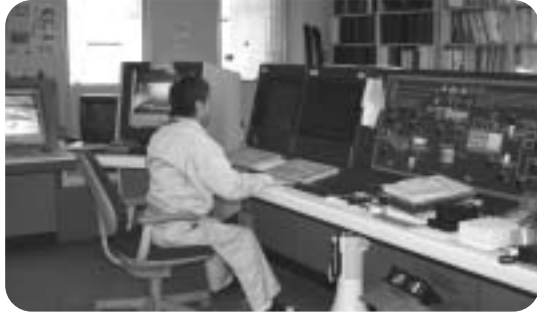
玉造浄水場中央監視室
