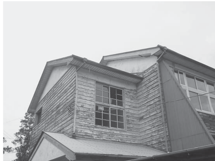
被災した旧佐原第二中学校校舎
