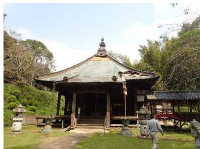
市・真浄寺本堂(屋根破損、畳汚損)
