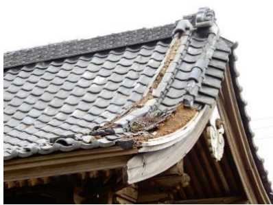
市・実相寺山門(瓦破損、袖塀倒壊)
