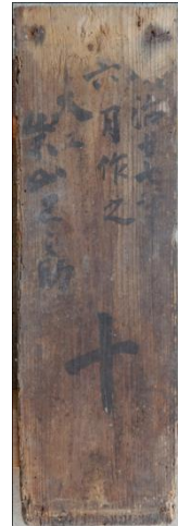
廊下床下の墨書
