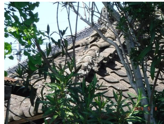
○瓦がずれている箇所
