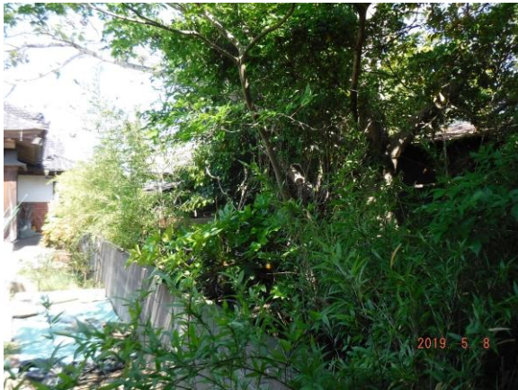
○越境した樹枝（写真左側は隣地）
