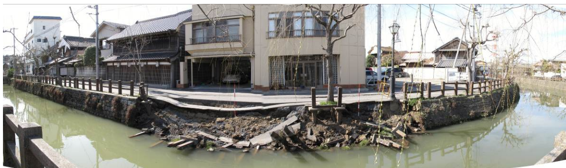
崩壊した小野川護岸(重伝建地区)
