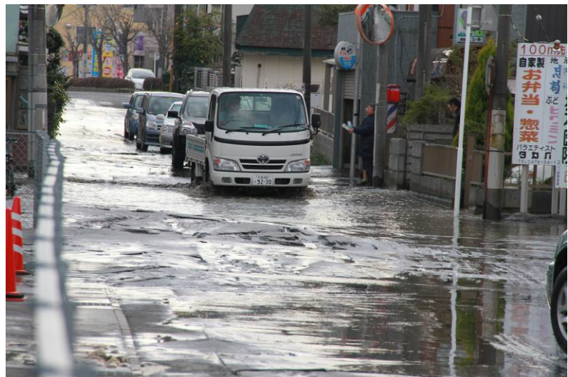
液状化により泥水が噴出した道路(水郷町)
