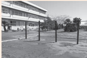
液状化により校舎は傾き半壊に
