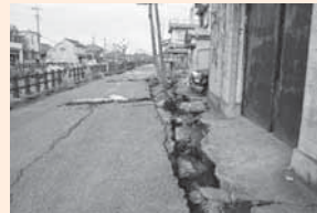
地面に亀裂が入り、電柱が傾く
