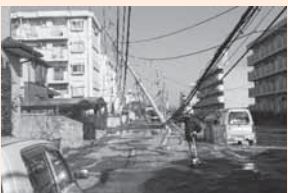
液状化により電柱が大きく傾き、電線が垂れ下がる
