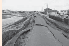
横利根川堤防が崩れ、路面に亀裂と歪みが生じる
