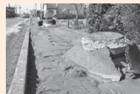
液状化により浮き上がった下水道のマンホール
