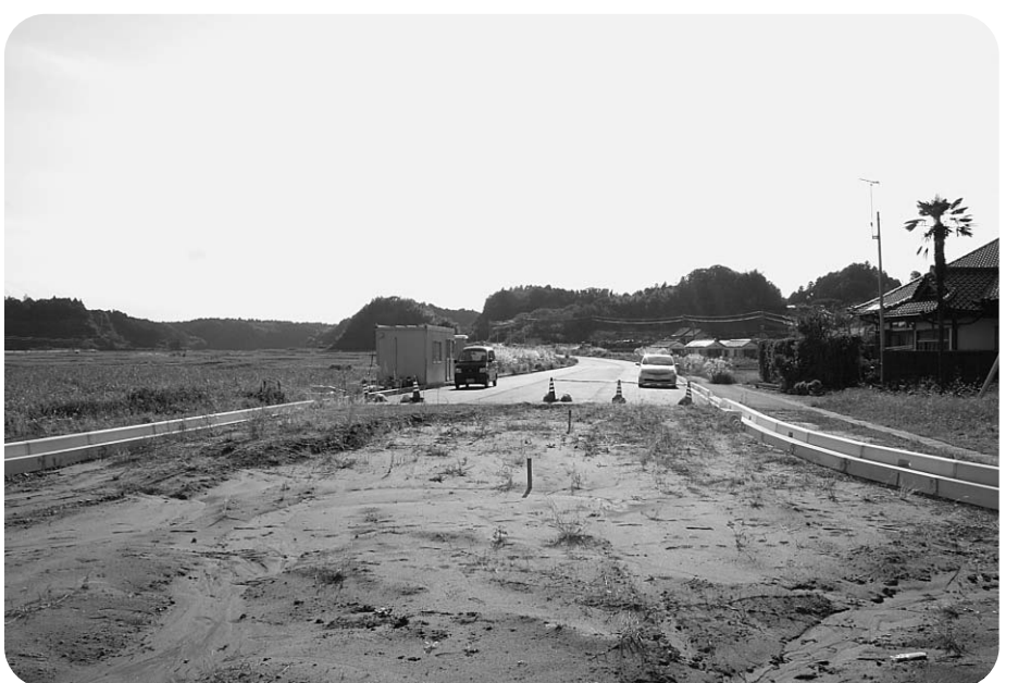
整備中の主要地方道成田小見川鹿島港線竜谷バイパス(虫幡)
