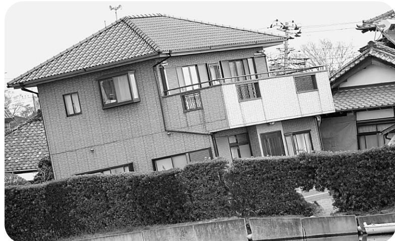
市内の液状化被害を受けた住宅
