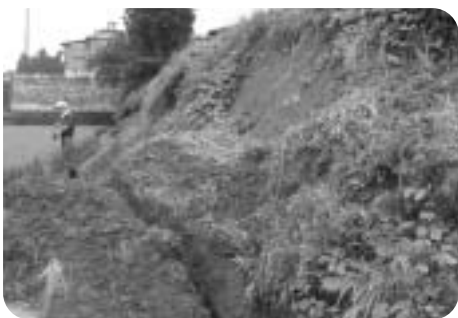
台風4号による法面崩壊(山田区小川地先)
