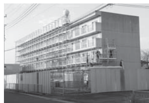
より快適な住環境へ大規模改修工事が進む市営住宅粉名口団地
