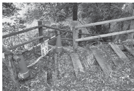
大変危険な老朽化した階段
