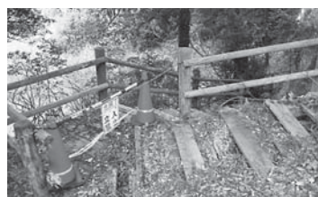
大変危険な老朽化した階段
