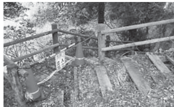
大変危険な老朽化した階段
