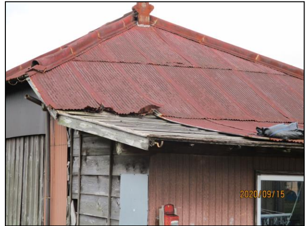
○屋根材の欠落、めくれ
