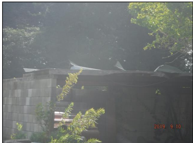
○車庫 屋根トタンのめくれ
