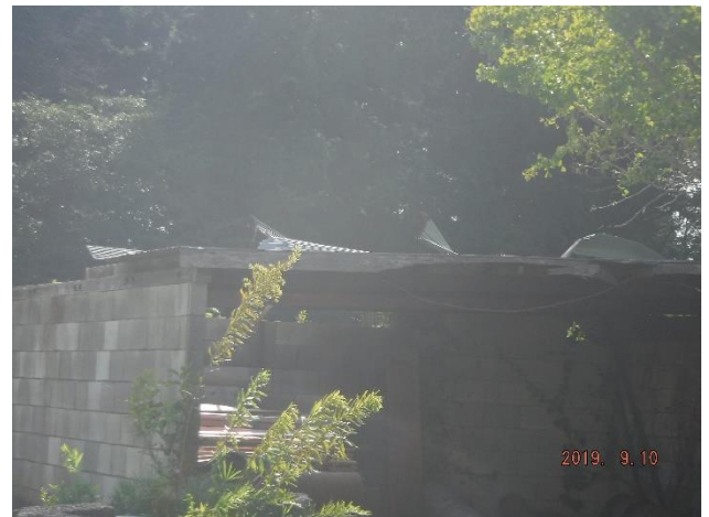
【車庫 屋根トタンのめくれ】
