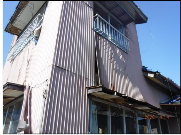
○軒、外壁の破損
