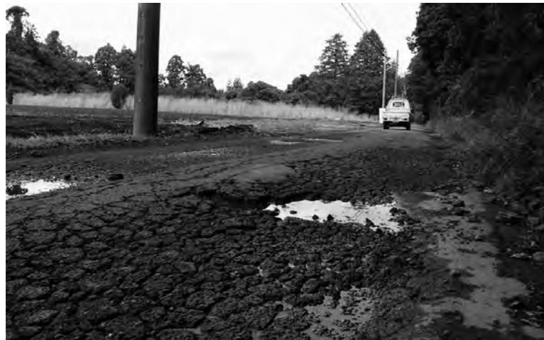
破損が著しい大角の市道
