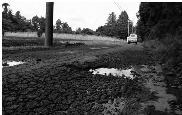
破損が著しい大角の市道
